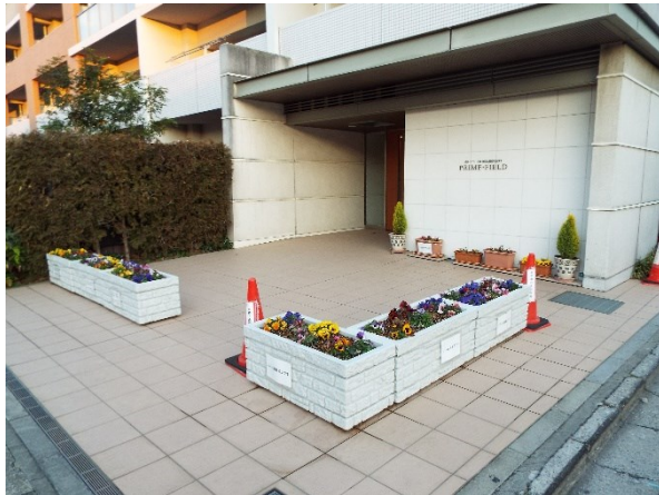
大規模修繕前の写真（白壁が汚染されています）
