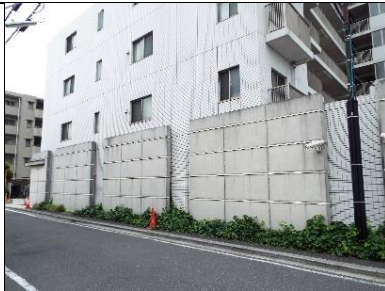
汚染がタイル部分より激しい
