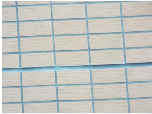
マンション外壁のシール材の軟化現象を指摘
