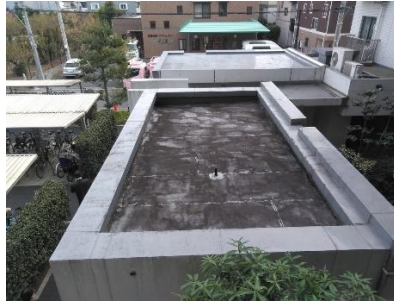
ゴミ置き場と電気室の屋上の汚れ
