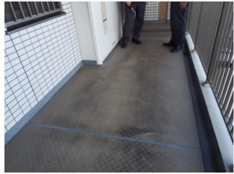
共用廊下の黒ずみや床材の劣化を指摘
