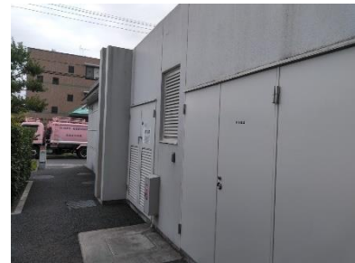
電気室北側壁面も汚れが出ています
