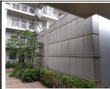
そばで見ると汚れが目立ちます
