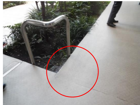
左記写真のずれのために雨水が廊下に落下
