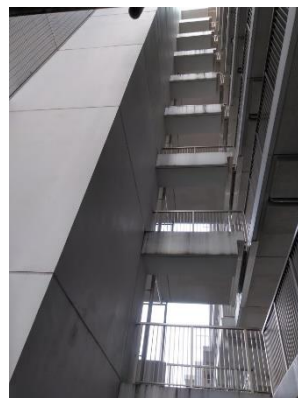
渡り廊下の汚染と対策
