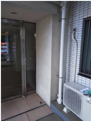
ロビー出入口柱の汚染
