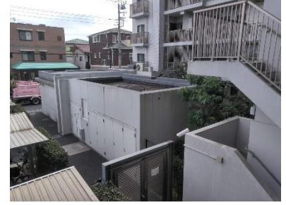
電気室の屋根、西側壁面の汚染
