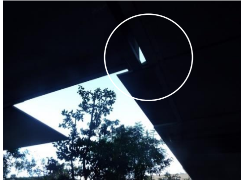
1階南棟と北棟の接触部分の雨水処理の不具合を指摘
