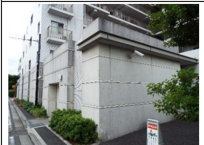
壁面の汚染と損傷が激しい
