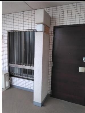
廊下の飾り柱の汚染
