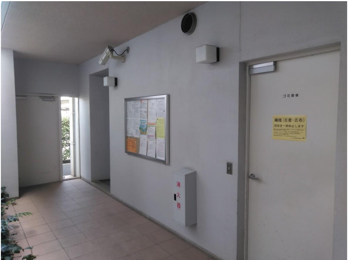
タイル床の汚染が進んでいます。現状ではブラシ線状が困難。対策を考えます。
